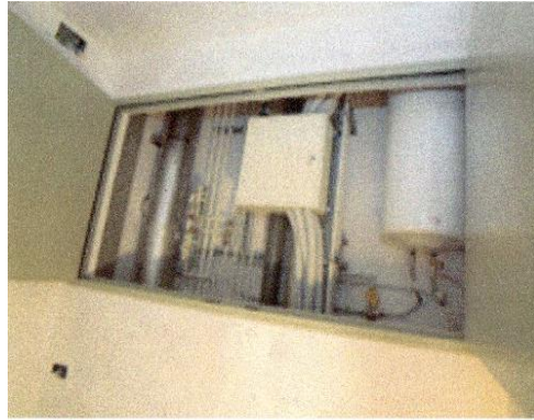
Patinillo de instalaciones
